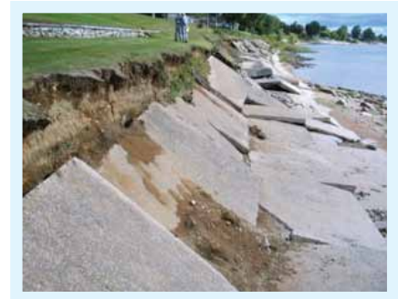
Figure 5. Érosion d'une berge artificialisée en bordure du fleuve Saint-Laurent.
